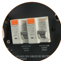
Disjoncteurs différentiels en entrée et sortie 230 V
